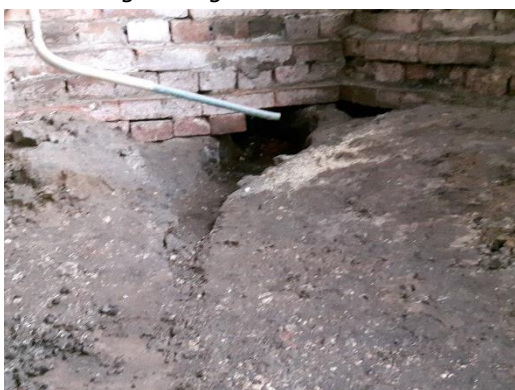
De doorgang in de muur naar de gang bij de watermeter, waarlangs het water het riool in stroomt.
