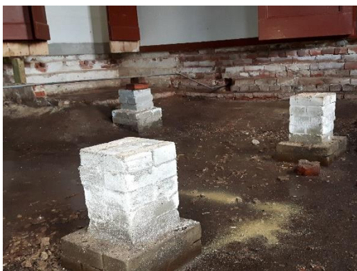
De kruipruimte / betonnen bak met daarin stiepen om de balklaag te dragen.
