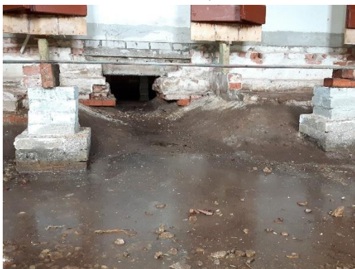
Op de foto hierboven: de opening naar achter waar het water van onder de keuken stroomt.
